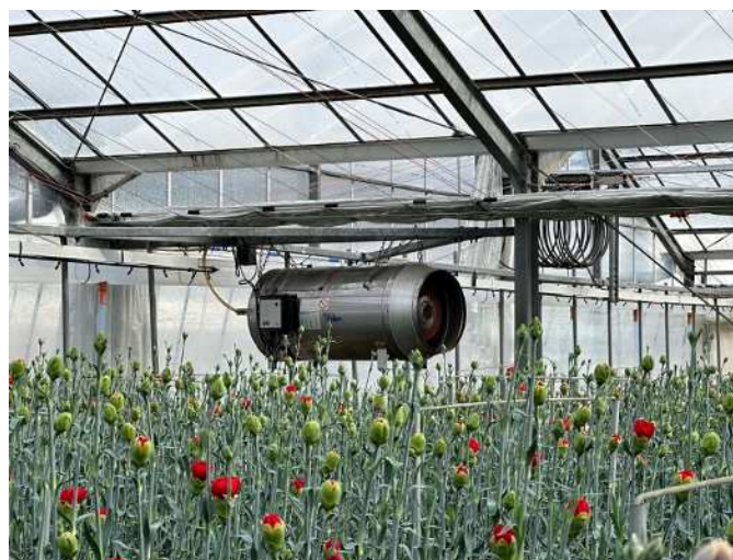
導入した炭酸ガス発生装置
